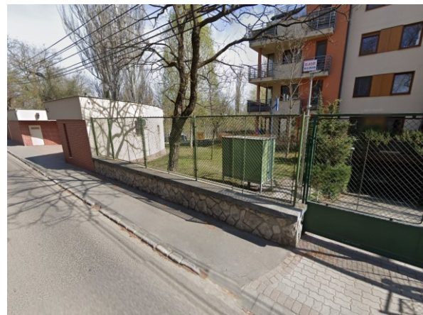
Lemezházás nagyközep/ kisnyomású gáznyomásszabályzó (forrás: maps.google.com)
