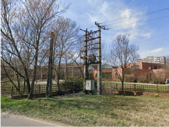
0340 sz. ELMŰ 20/0,4 kV-os transzformátora és tartószerkezete (forrás: maps.google.com)
